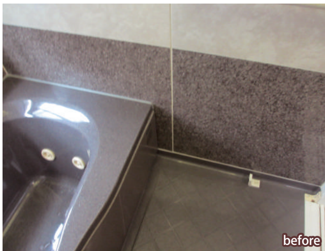
before 車いすから移乗する入浴台を製作しました。浴そう内に洗体時の水が入らないよう、2段にしています。
