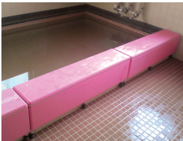
浴そう縁が石パネルになっており、角でケガをしてしまう恐れがあったので保護するカバーを設置しました。 05-44-01
