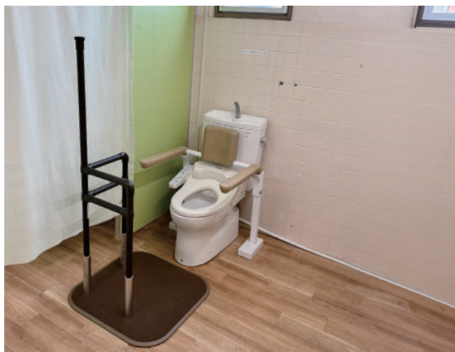
11-48-01 L型手すりと縦手すりで、トイレからの移乗動作や立ち上がったあとの立位保持をサポートします。
