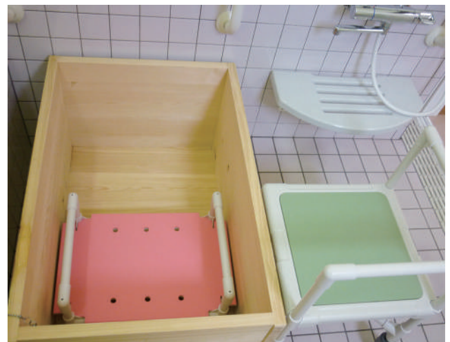
座位入浴で安全に浴そうの出入りを行い、浴そう内で体を支えられるようにグリップ付浴そう内いすを設置しました。 61-41-04
