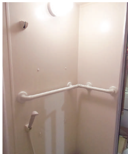
一連の手すりです出入口から浴そうまでの移動を補助します。 61-33-06
