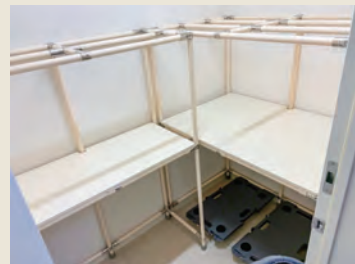
収納棚 足元にミニポリトラを敷くことで、 品物の出し入れがしやすくなります。
